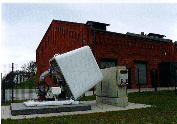
FOT. 5 Zmodernizowana studnia głębinowa
